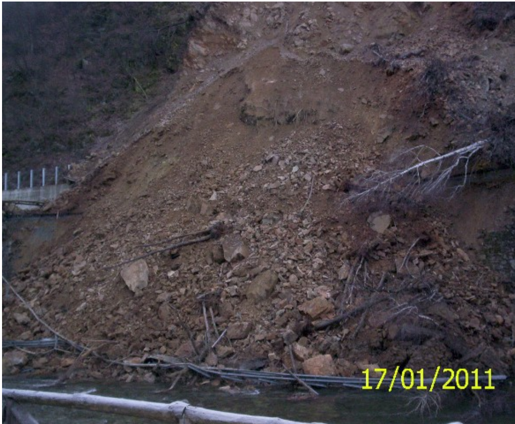
Il crollo del muro di sottoscarpa
