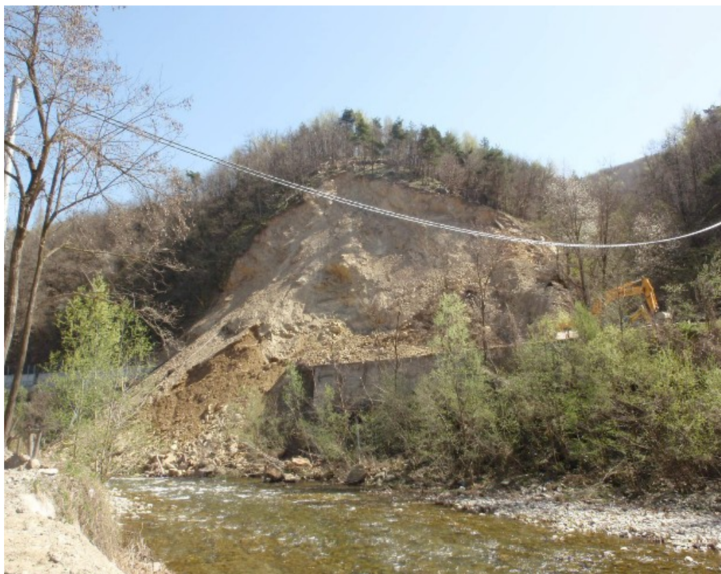
Il versante franato dopo i lavori di somma urgenza
